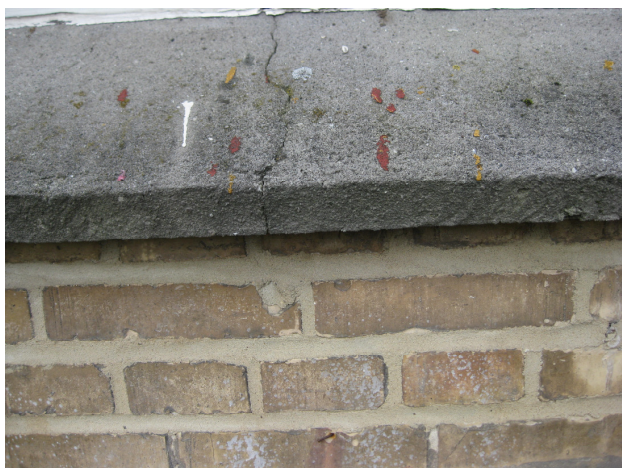
Sålbænke mod gården viser kraftige tegn på nedbrydning
