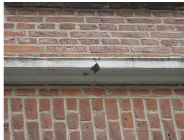
Der ses partielle revner og nedbrydning af overflade på gesims.
