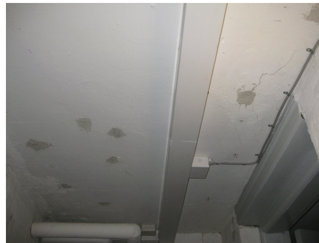
Loft i kældre er udført som malerbehandlet puds på forskalling. Der ses områder med mindre revner og reparationer.
