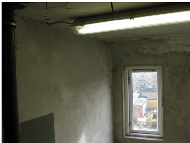
Der ses revner af ældre dato i puds på vægge og loft over den oprindelige bagtrappe (badeværelser). Revner er ikke af væsentlig betydning for konstruktionen
