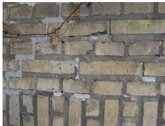
Der ses områder på gårdfacade, som trænger til omfugning og reparation/forstærkning ved revnedannelser.
