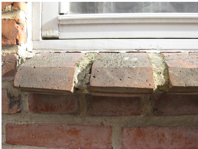
På gedefacade ses nedbrydning af sålbænke under vinduespartier, samt fugeslip omkring vinduer
