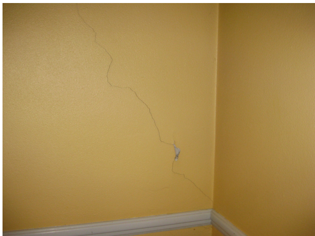
Der ses enkelte revner i pudsede vægge i trapperum Bør opskæres og forstærkes i f.m. maling af trapperum
