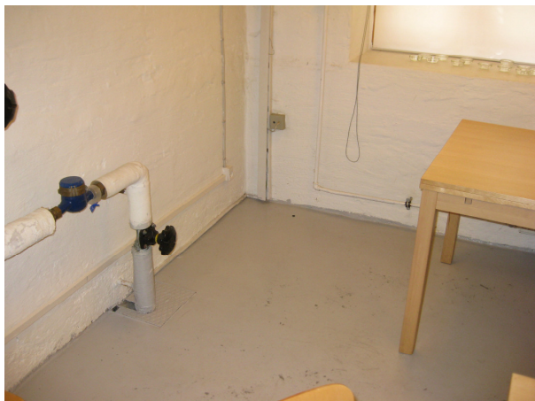
Hovedvandstik med måler er tilgængelig i kælderrum
