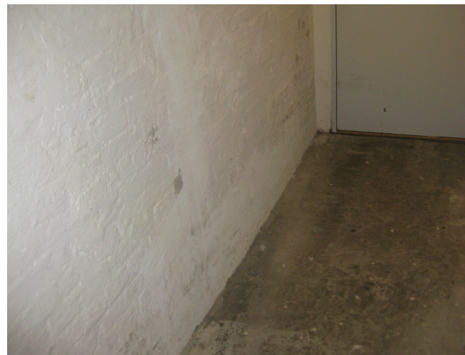
Der ses på vægge områder med afskallende puds. Afskalninger er i mindre omfang og naturligt forekommende i ældre ejendomme med opmurede kældervægge.
