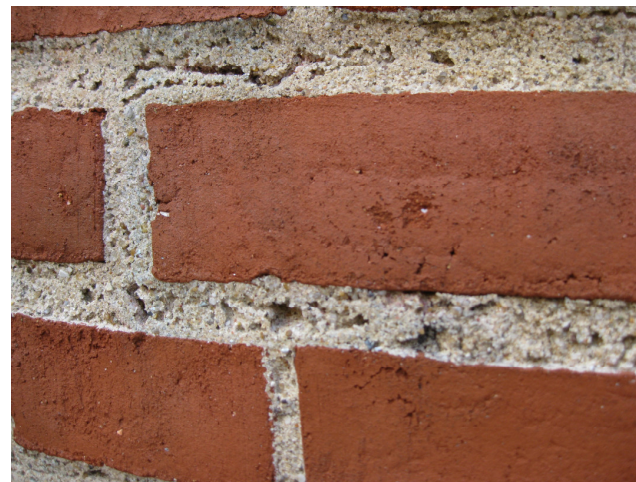
Minder områder af på gedefacade er under nedbrydning pga. fjernelse af graffiti.
