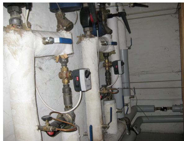
Fjernvarmeforsyning og hovedmåler. Blandesløjfer og motorventiler for styring af varmesforsyning. God stand
