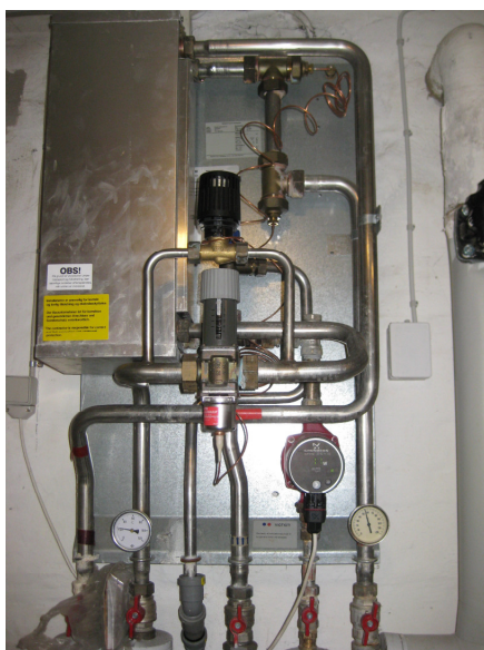
Brugsvandsveksler med cirkulationspumpe og reguleringsventiler. God stand
