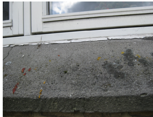
Vinduer er under nedbrydning og der ses fugeslip
